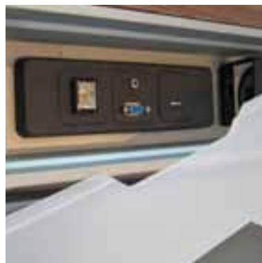
In der Kabelführung verdecktes Anschlussfeld
